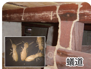
シロアリによる被害
