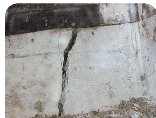
基礎のひび割れ
